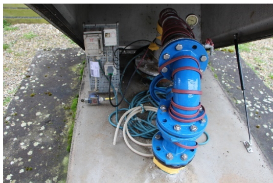
Installationer i boringen.
