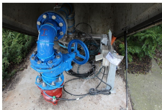
Installationer i boringen.
